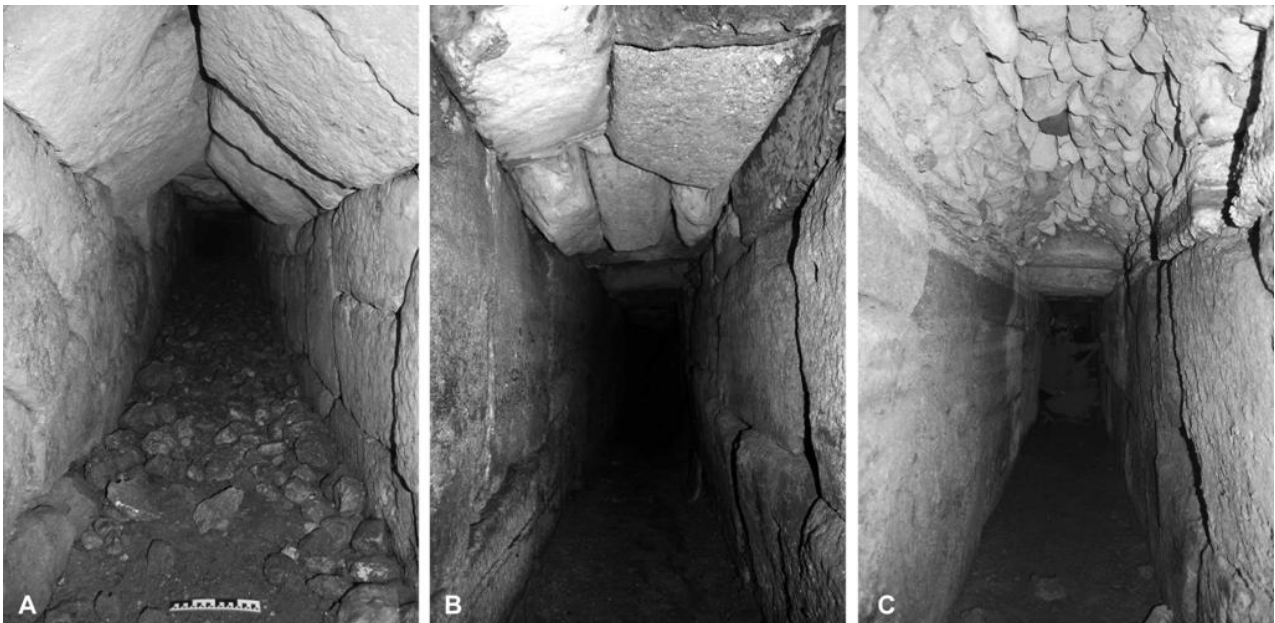
Fig. 22. Exemples de couvertures atypiques. A. Couverture en bâtière dans un diverticule du collecteur principal. B. Couverture voûtée de gros blocs dans la branche ouest du collecteur sous le macellum . C. Couverture voûtée maçonnée dans cette même branche du collecteur.
